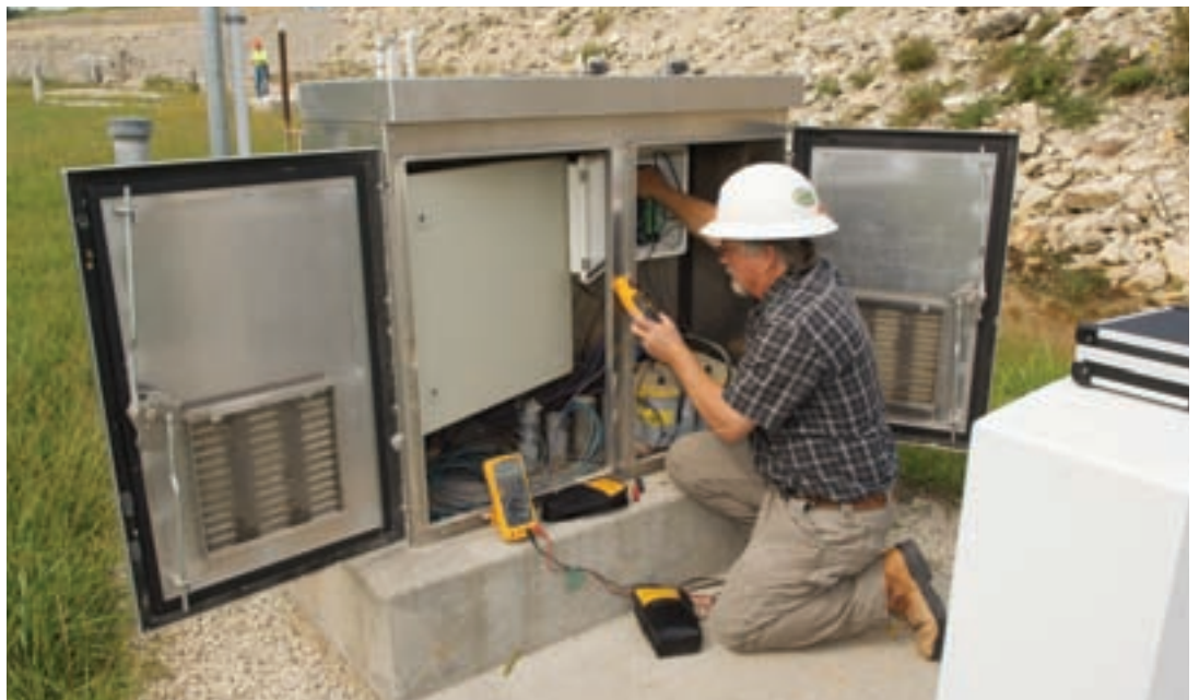
Bob Frazey 负责横跨大坝基底的一个传感器服务仪表板。这些服务仪表板皆为低压仪表板，房屋地面膨胀传感器通信和支持系统。他使用 Fluke 189 数字万用表检测来自附近一个太阳能电池板的 12 伏直流电池充电系统。他同样使用 Fluke 773 毫安级过程钳形表来检测来自压力传感器和换能器的 4 mA 至 20 mA 的信号。
